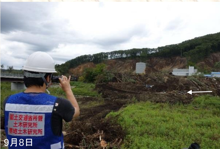
厚真川閉塞状況(浄水場付近、左岸堤防から右岸を望む)
