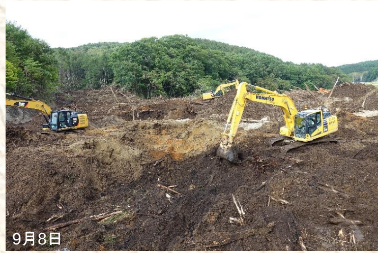
厚真川閉塞状況(幌内橋から上流を望む、下写真と同箇所)
