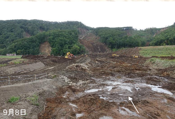
厚真川閉塞状況(厚幌ダム下流)
