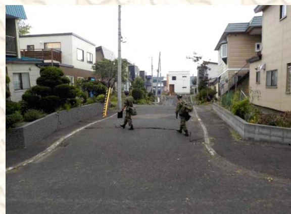
⑬住宅地での道路の陥没
