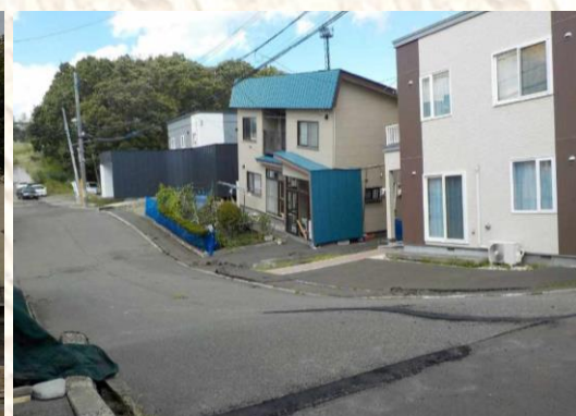
⑩道路の陥没および住宅の傾斜
