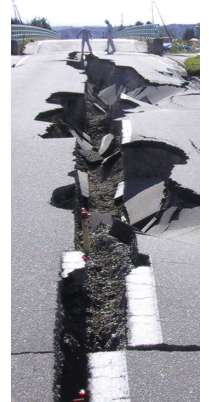
泥炭地盤上の 道路盛土の地震被害
