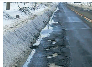
融解期の舗装の損傷例
