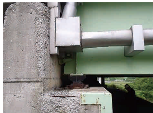
橋台に生じたスケーリング
