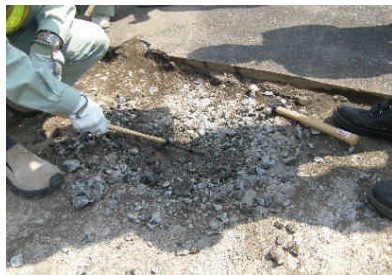
土砂化した橋梁床版
