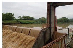
濁水が流下する頭首工付近の状況
