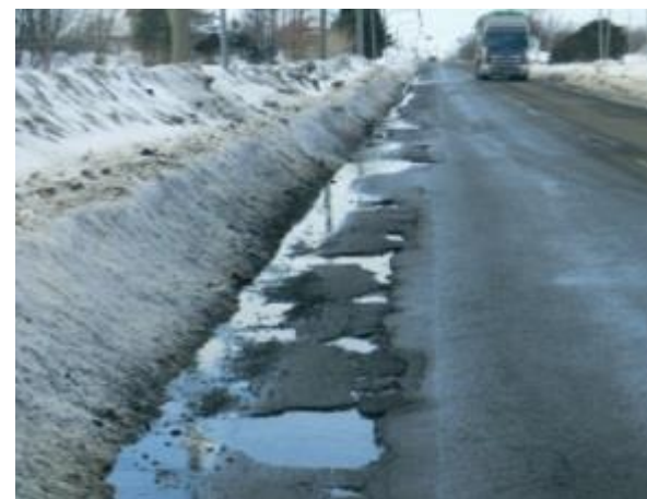
凍結融解・融雪水による 支持力低下や剥離(舗装)
