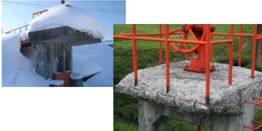
河川樋門の凍害
