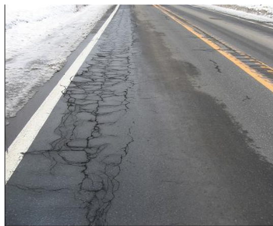
疲労クラック(舗装)
