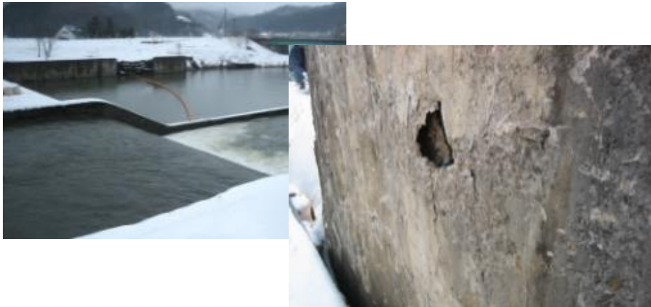
摩耗と凍害による複合劣化 (農業頭首工)
