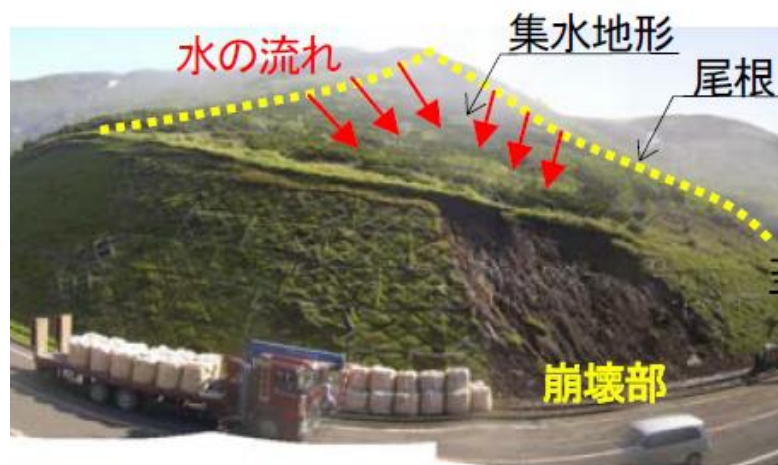
凍上・凍結融解を受けた のり面の崩壊(切土のり面)
