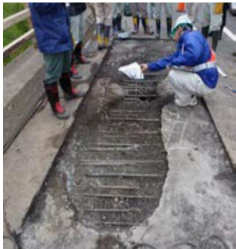
疲労・凍害・塩害の複合 (橋面舗装・床版劣化)
