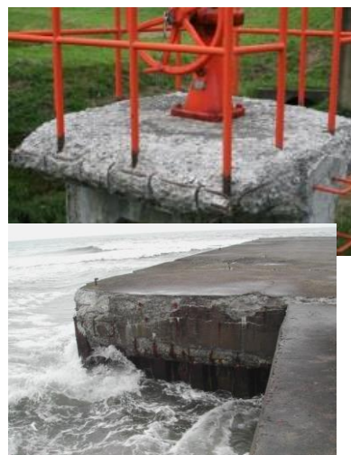
凍害や塩害・摩耗の複合 (樋門・沿岸構造物)
