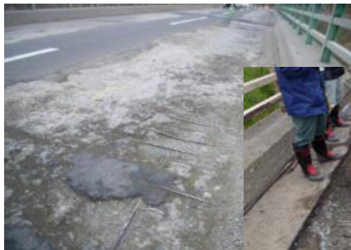
橋梁床版の 土砂化
