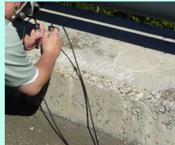
道路橋地覆での凍害調査 (建設部からの技術相談により実施)
