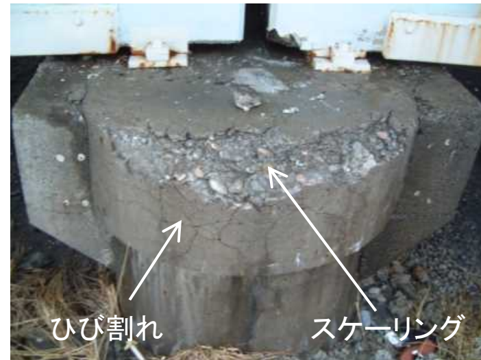
凍害を受けたコンクリート
